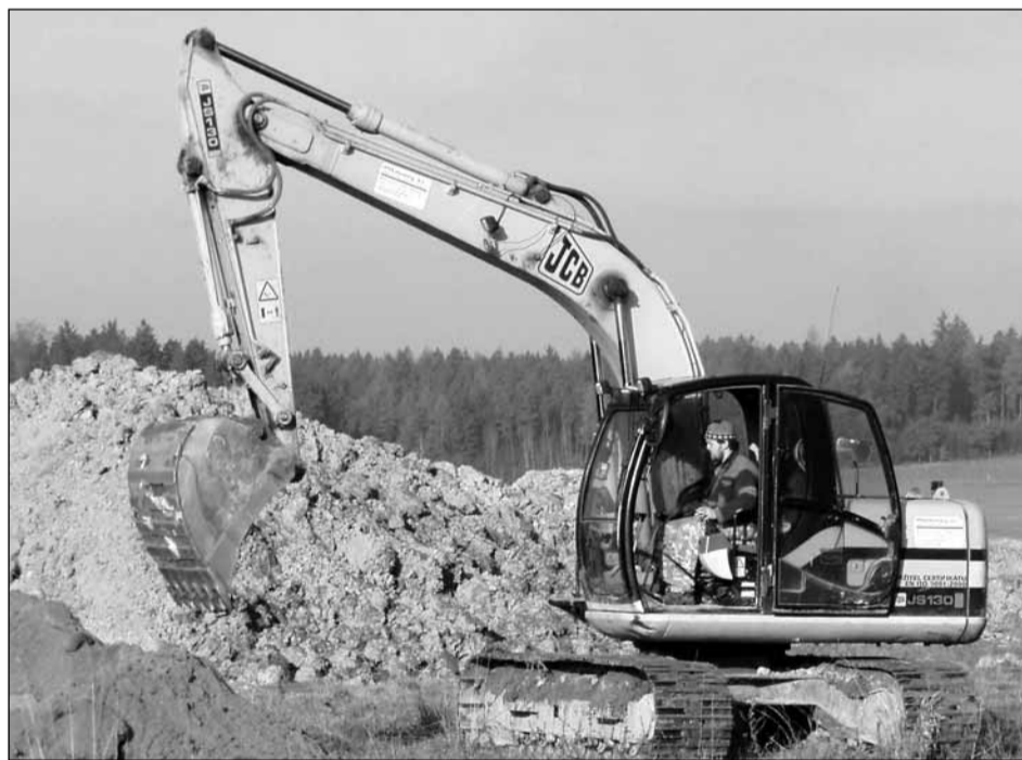
Nová výstavba. Malé sídliště na okraji Petrovic se dočká rozšíření. „Vznikne zde na padesát bytových jednotek, slibujeme si od toho další navýšení počtu obyvatel. Stavbu provádí developerská firma, která dodá všem zájemcům bydlení na klíč,“ prozradil starosta Vladimír Paulík. Foto Bohumil Hlaváček
