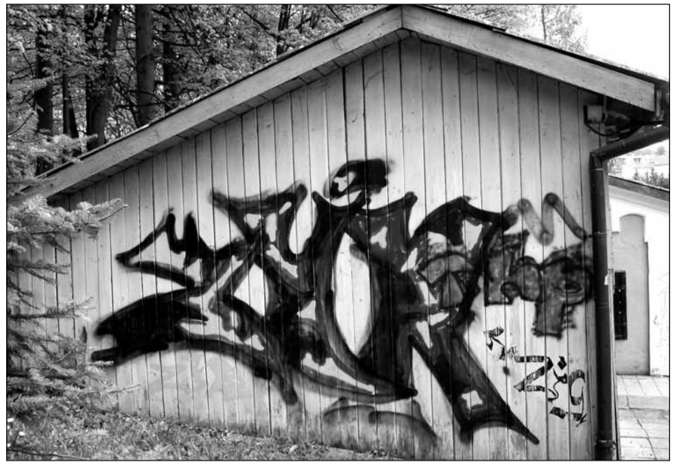
Vandalismus. Lysické kino zdobí výtvoři sprejerů. Škody jdou do tisíců korun. Foto Pavel Šmerda
