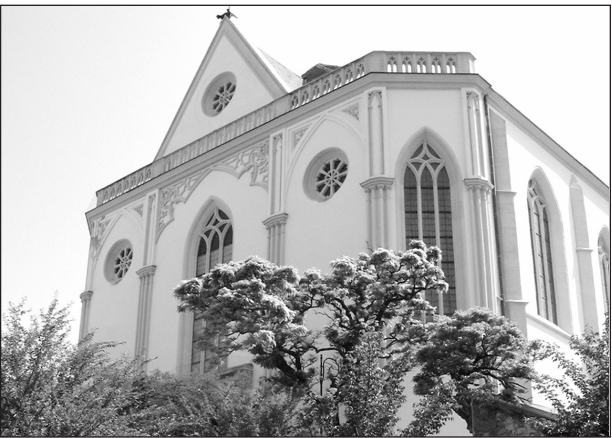
Kostelní zeď. V případě neřešení havarijního stavu zdi by mohl být v ohrožení i kostel svatého Jakuba. Foto Radim Hruška
