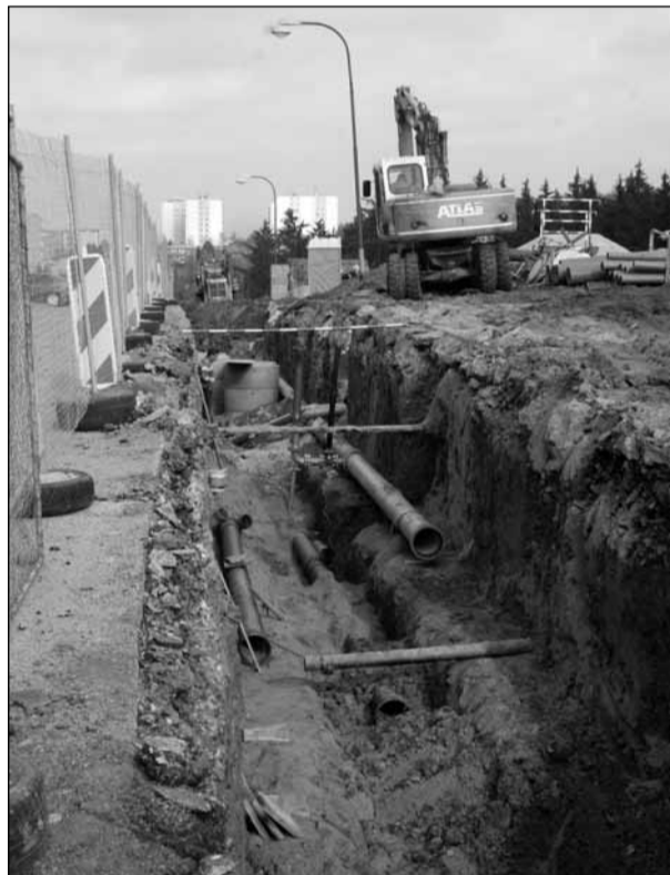
Výstavba. Po zbourání likusového objektu bývalého Domu dětí a mládeže vznikla Pod Sanatorkou v Blansku atraktivní stavební místo. Developerská firma tam již zahájila stavbu inženýrských sítí pro budoucí domky. Foto Bohumil Hlaváček
